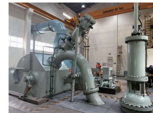
水力発電による電力を活用しています。(ワンサラ鉱山)
