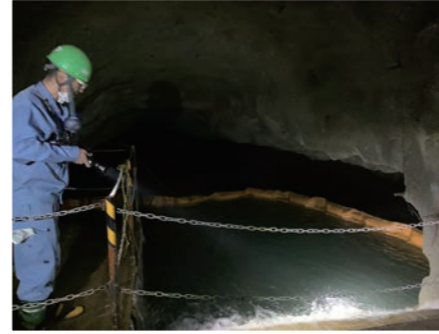
【左】 神岡鉱山の坑内にあります坑内水処理用の4,000t沈殿池(神岡鉱業)。
