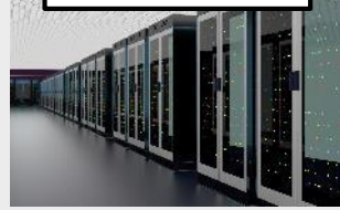
データセンター (ヒートシンク)
