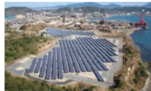
彦島製錬太陽光発電施設
